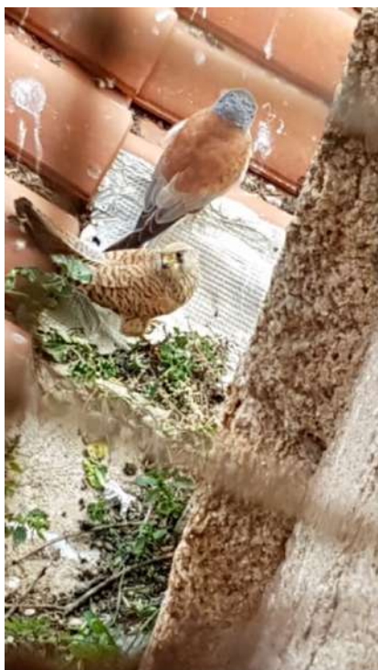
Fig. 10. Nido natural en hueco de teja partida en la cubierta de la iglesia de San Vicente Mártir.
