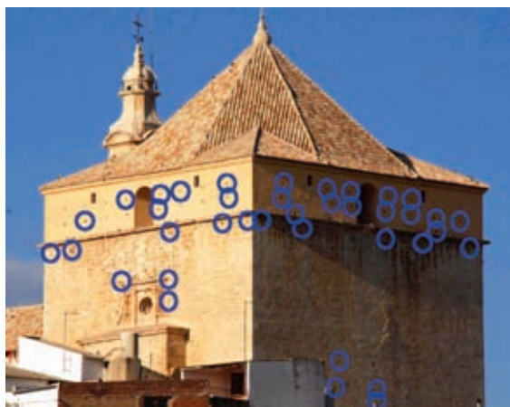
Fotografía 1. Ubicación de mechinales en la fachada de la Iglesia de la Asunción.
