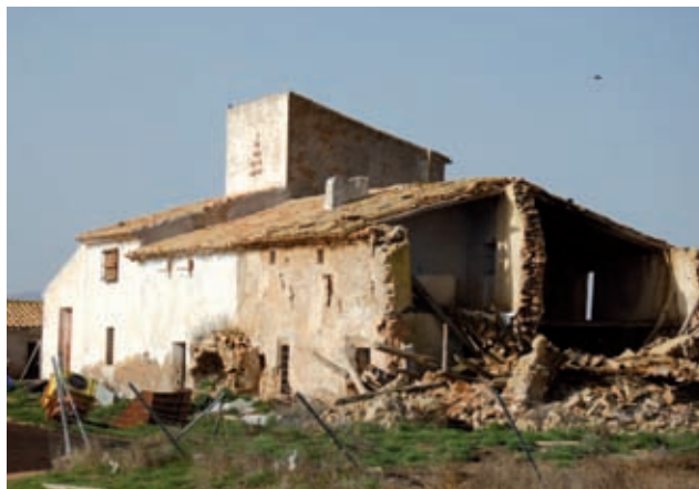
Figura 5. Estado ruinoso de los edificios ocupados.
